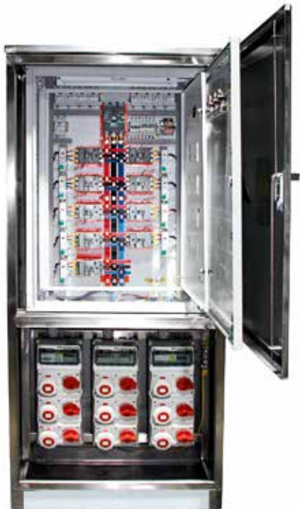
Electro Enchufe destaca que los tableros eléctricos se vienen acoplando a los avances tecnológicos.
