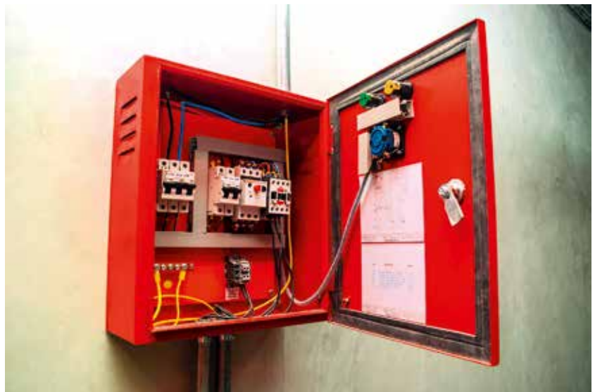
Los tableros eléctricos pueden usarse para sistemas de bombeo o sistemas contra incendios. Proyecto: Edificio Nova – Hidromec Ingenieros.
