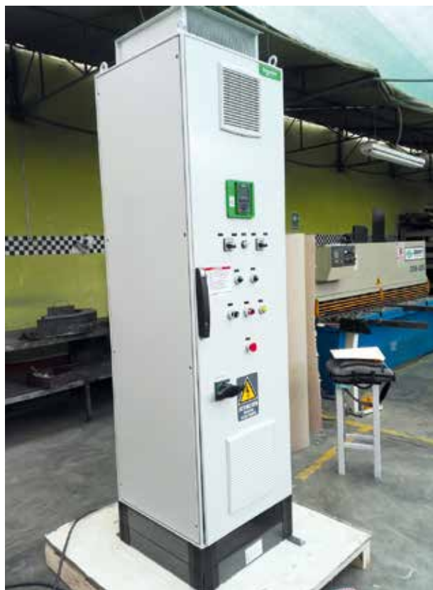
Para la instalación de los equipamientos internos, Sonepar sostiene que es básico distribuirlos según lo determinado en los planos y acorde a la norma IEC 61439.
