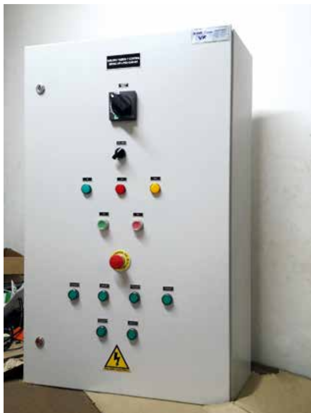
Sonepar resalta la importancia de que los tableros eléctricos cumplan con la norma IEC 61439.
