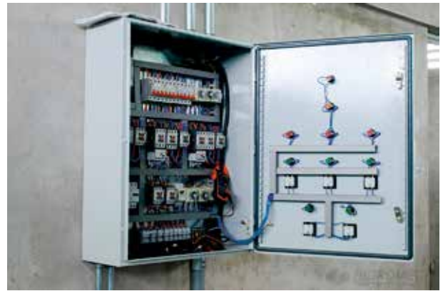
Según Hidromec Ingenieros, la limpieza de los tableros debe realizarse trimestralmente. Proyecto: Parque Zonal Ancón - Hidromec Ingenieros.
