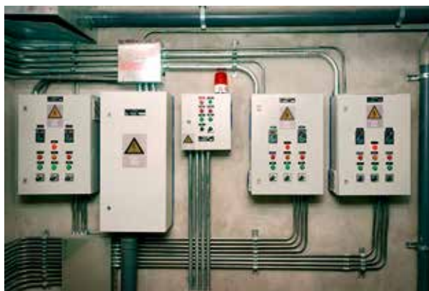
Según Hidromec Ingenieros, es importante comprobar que el tablero no presente ningún tipo de defecto para garantizar su correcto funcionamiento. Proyecto: Condominio Bella Flora - Hidromec Ingenieros.
